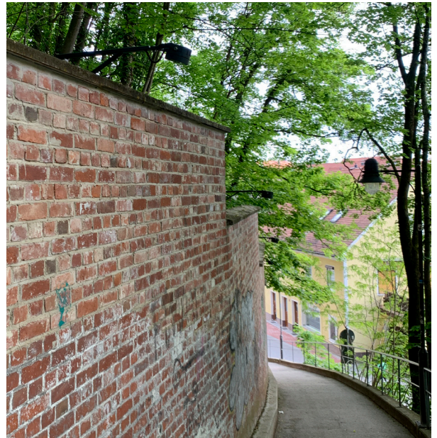
Abbildung 16 : Beleuchtung an der Mauerkrone
